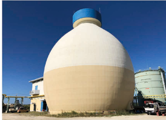
汚泥消化タンク
