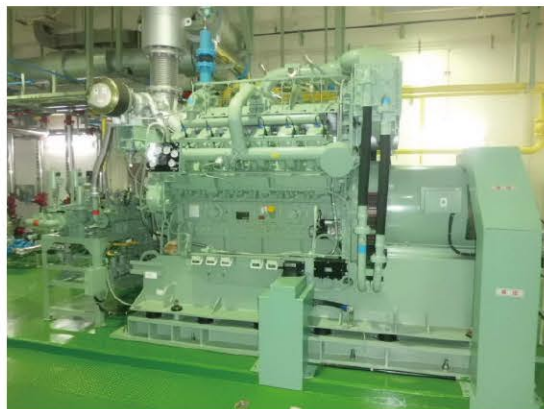
消化ガス発電機
