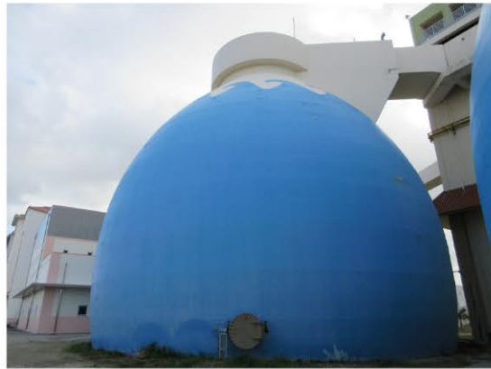
汚泥消化タンク
