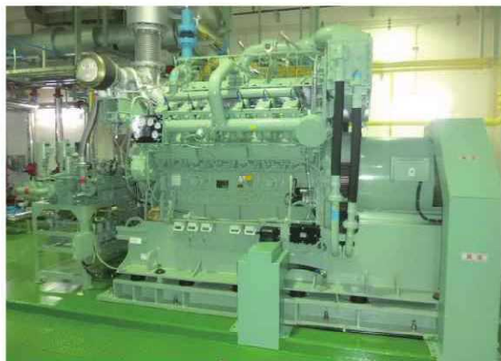
消化ガス発電機
