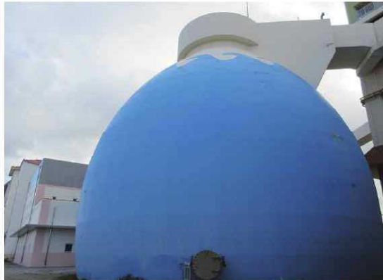
汚泥消化タンク
