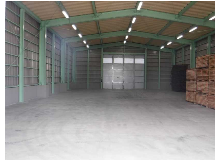
【木材加工製品保管施設 (内部)】
