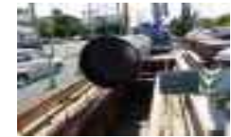
(耐震管) 送水管
