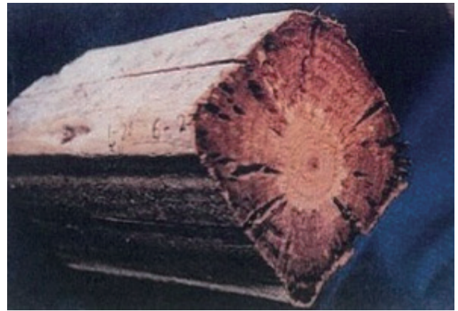
木材腐朽菌による被害状況
