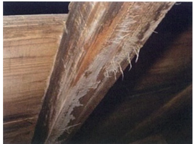
木材腐朽菌による被害状況
