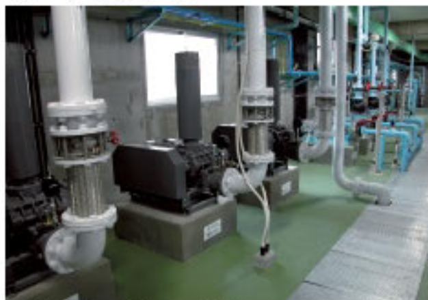
ポンプ・ブロウ設備
