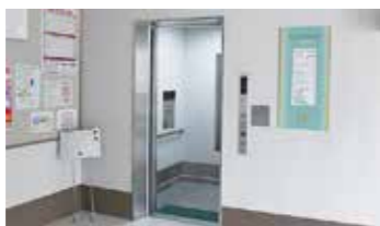
エレベーター
