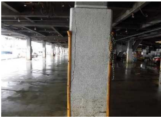
支柱のひび割れ
