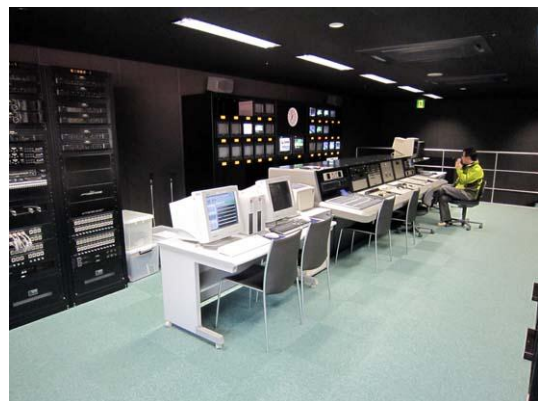
大型映像装置操作室
