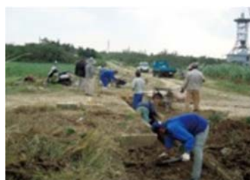
赤土等流出防止施設の機能維持
