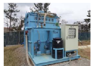
濁水凝集処理装置
