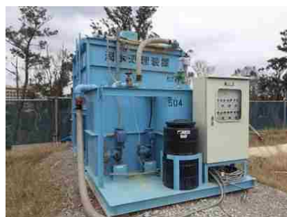
写真16 濁水凝集処理装置
