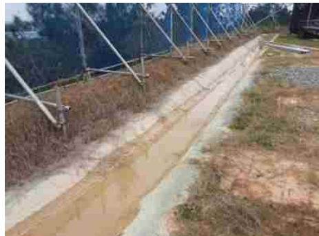
写真14 場内仮設排水路
