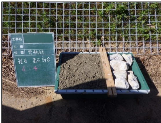
図-2.4.11 籠内の詰め材料(恩納村) ※恩納村試験地は、沈砂池に流れ込む水量等が少ないと判断されたことから、軽石をより多く使用する目的から宜野座村より投入量を多くし、軽石:栗石の割合を6:4とした
