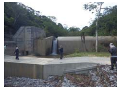
写真 溪流取水施設
