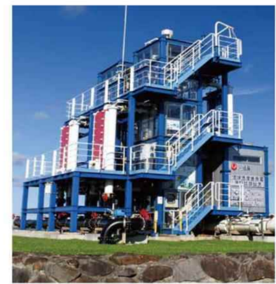
海洋温度差発電実証試験設備 (久米島町)
