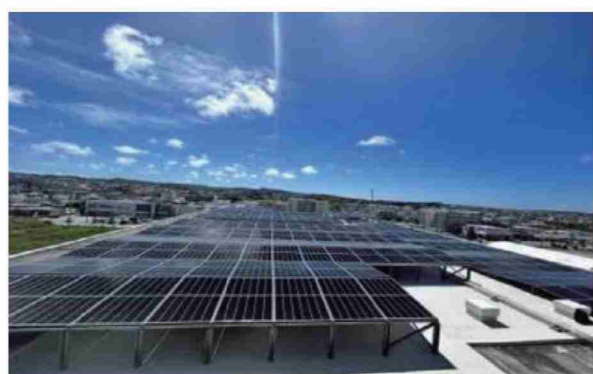
八重瀬町庁舎における太陽光パネル
